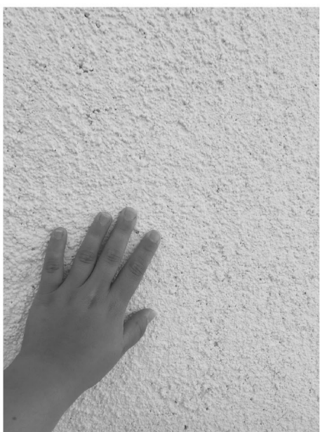
Parede de Reboco Areado
